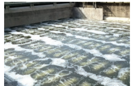
Neue Belüftung im Belebungsbecken der Kläranlage Buchenhofen
