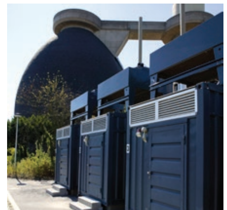
Energie aus dem „nachwachsenden Rohstoff“ Abwasser: Auf vielen Kläranlagen des Ruhrverbands wird, wie hier auf der Kläranlage Hagen, das anfallende Faulgas in Blockheizkraftwerken zur Stromerzeugung genutzt.
