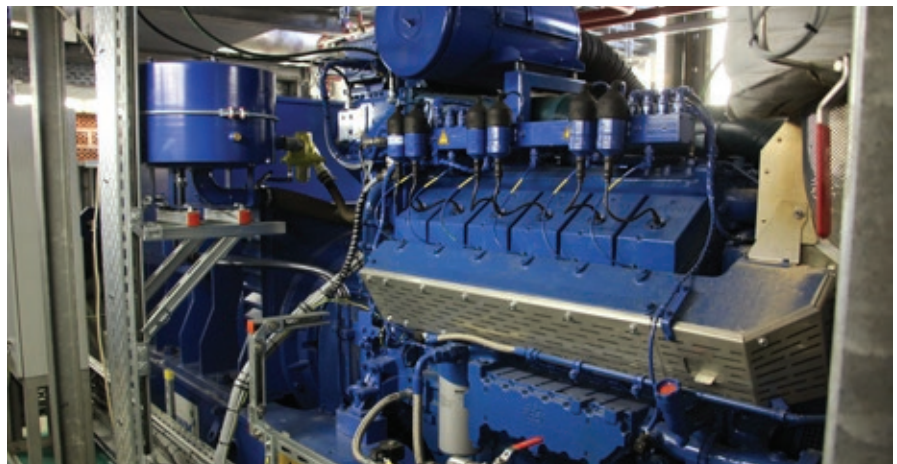
Eines der vier 600-kW-BHKW-Module der Kläranlage Buchenhofen
