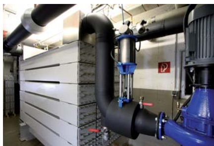
Schlammkuperator der Kläranlage Bestwig-Velmede in Modulbauweise, Quelle: Archiv Ruhrverband
