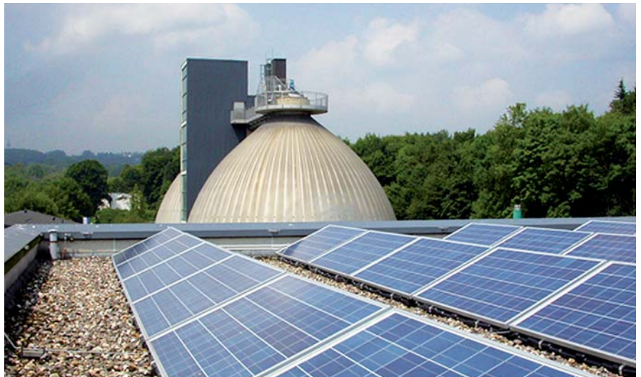
Photovoltaikanlage in Kohlfurth, Quelle: Wupperverband
