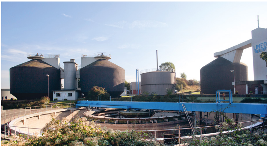
Links: Klärschlammfaulbehälter und Gasbehälter auf der Kläranlage Duisburg-Rheinhausen (LINEG) Unten: Schlammverbrennungsanlage Buchenhofen (Wupperverband)
