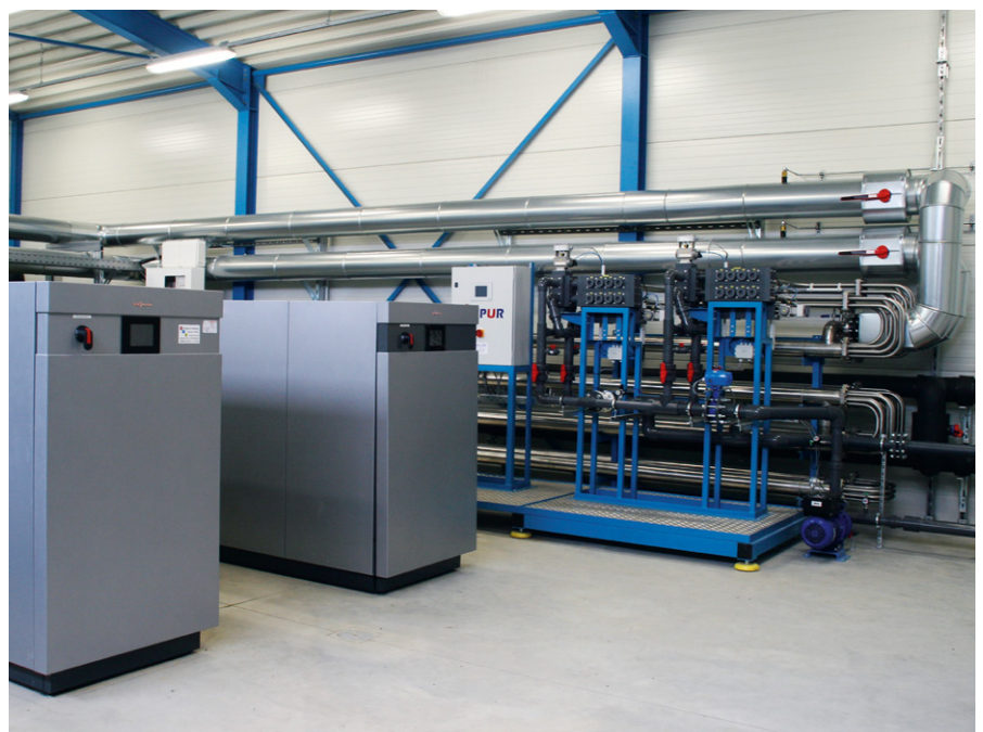
Anlage zur Wärmenutzung aus Sumpfungswasser beim Erftverband
