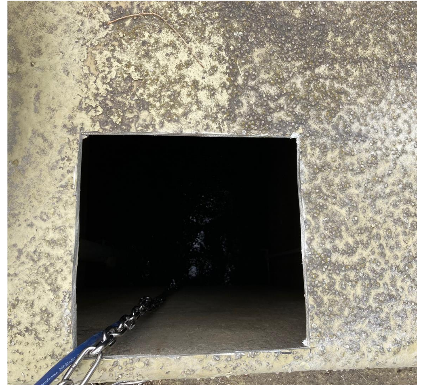
Verbaute Sonde in der Denitrifikation
