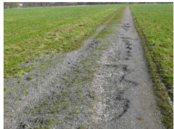
Bild 4: Zustand eines wassergebundenen Weges in der Gewässeraue nach dem Hochwasser (Foto: E. STÄDTLER)
