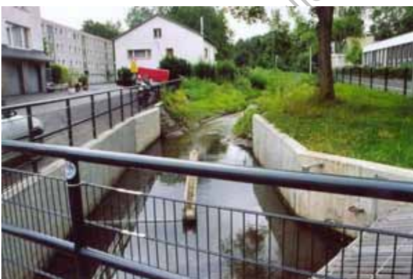
Bild 42: Sicherungsmaßnahmen um einen Sandfang in Betonbauweise am Endenicher Bach im Bereich der Stadt Bonn; massives Schutzgeländer im Wohngebiet (Foto :E. STÄDTLER)
