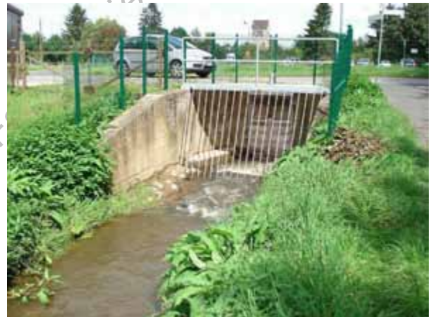
Bild 41: Sicherung eines Einlaufbauwerks durch ein Schutzgelenk, eine Umzäunung und einen Senkrechtrechen (Foto: E. STÄDTLER)
