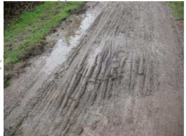
Bild 3: Zerfahrener Radweg ist noch akzeptabel (Foto: EMSCHER-GENOSSENSCHAFT, LIPPEVERBAND)
