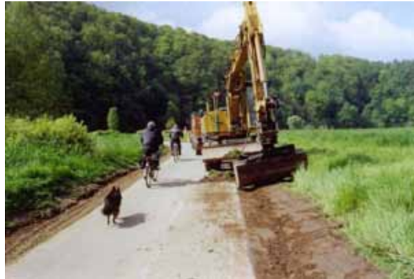
Bild 34: Fehlende Absperrung beim Bankette Schälen eines uferbegleitenden Weges in der Gewässeraue (Foto: E. STÄDTLER)
