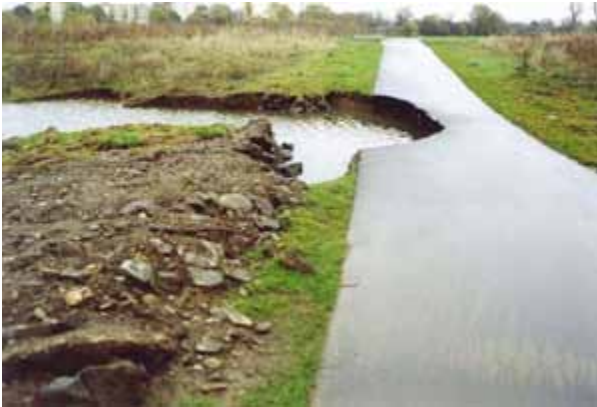
Bild 7: Schadstelle an einem Rad- und Wanderweg in der Aue nach dem Hochwasser. Hinweise auf Gefahrenstelle oder Absperrung fehlen (Foto: E. STÄDTLER)
