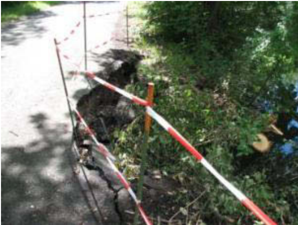
Bild 5: Zustand eines asphaltierten Waldweges nach Umsturz einer Weide in der Uferböschung – der Schaden ist durch den Verkehrssicherungspflichtigen unmittelbar abzusichern und zu beheben
