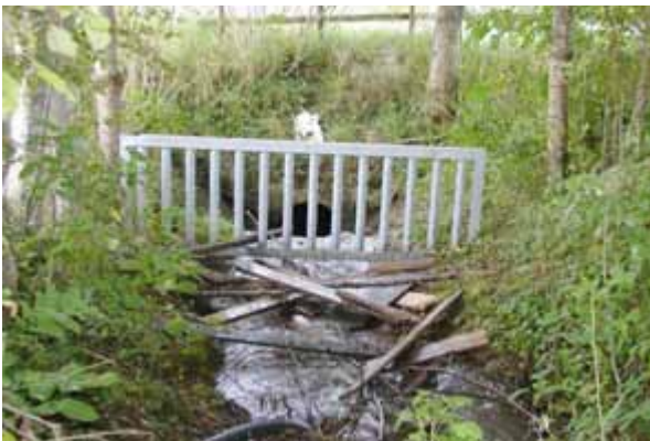
Bild 15: Treibholzrechen unmittelbar vor einer Verrohrung (Foto: R. SCHÖBERER)
