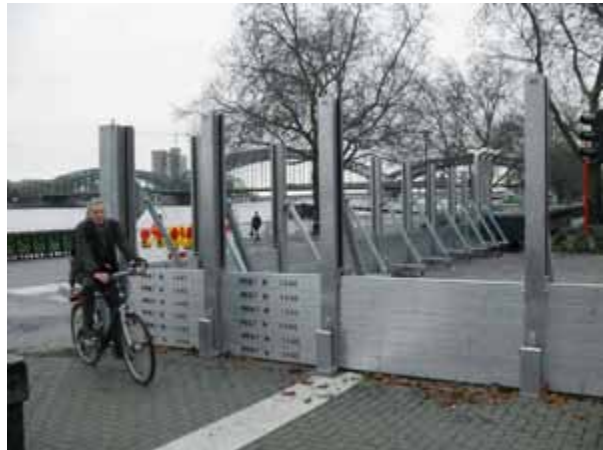
Bild 19: Fußgänger und Radfahrer bewegen sich im Bereich der aufgebauten mobilen Hochwasserschutz-elemente am Rhein in Köln – HW Januar 2011. Zusätzliche Sicherung gegen Diebstahl und Beschädigungen durch Sicherheitspersonal (Foto: E. STÄDTLER)
