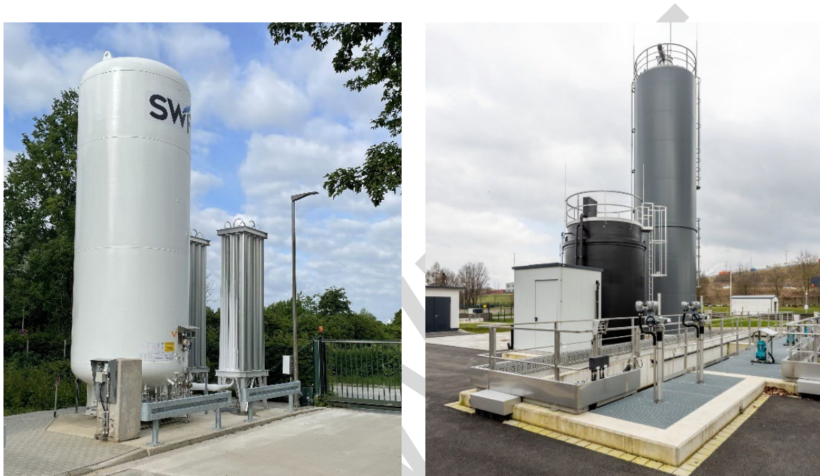
Abbildung 6: Sauerstofftank der Ozonung auf der Kläranlage Lemgo der Abwasserbeseitigungsgesellschaft Lemgo (links; Foto: Abwasserbeseitigungsgesellschaft Lemgo) und Pulveraktivkohlesilo auf der Kläranlage Brilon des Ruhrverbandes (rechts; Foto: Ruhrverband)
