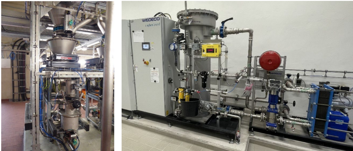
Abbildung 7: Pulveraktivkohle-Dosieranlage auf der Kläranlage Dortmund-Deusen der Emschergerossenschaft (links; Foto: LANUK NRW) und Ozonanlage auf der Kläranlage Lemgo der Abwasserbeseitigungsgesellschaft Lemgo (rechts; Foto: Abwasserbeseitigungsgesellschaft Lemgo GmbH)
