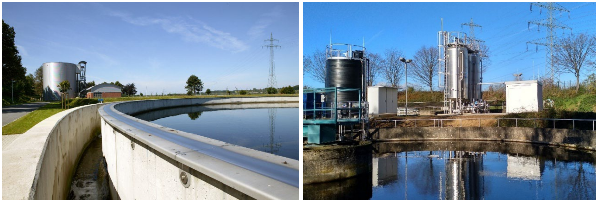
Abbildung 4: Nachklärbecken auf der Kläranlage Menden des Ruhrverbandes (links; Foto: Ruhrverband) und granulierte Aktivkohle-Filter auf der Kläranlage Bergheim Glessen des Erftverbandes (rechts; Foto: Erftverband)
